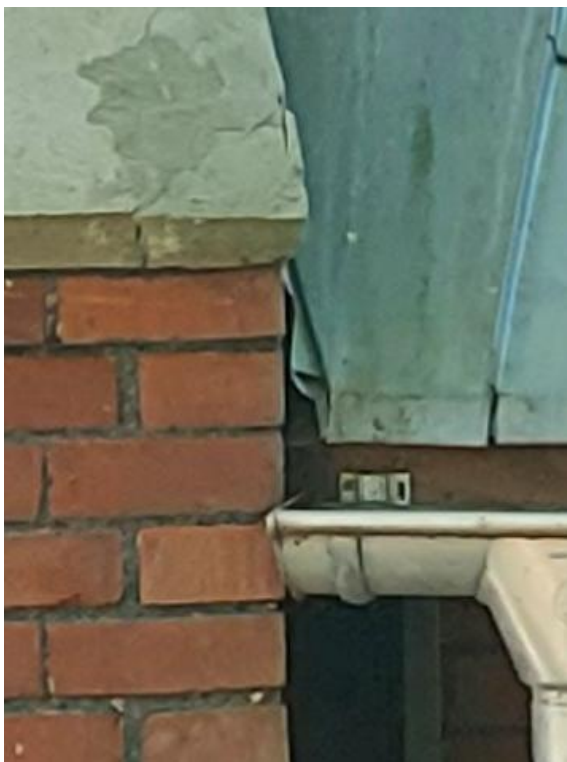
Fragment uszkodzonej obróbki blacharskiej i czapy na skosie przypery
