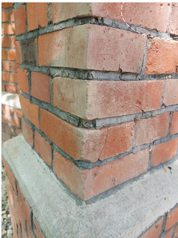
Fragment elewacji kaplicy – stan zachowania spoin w murze
