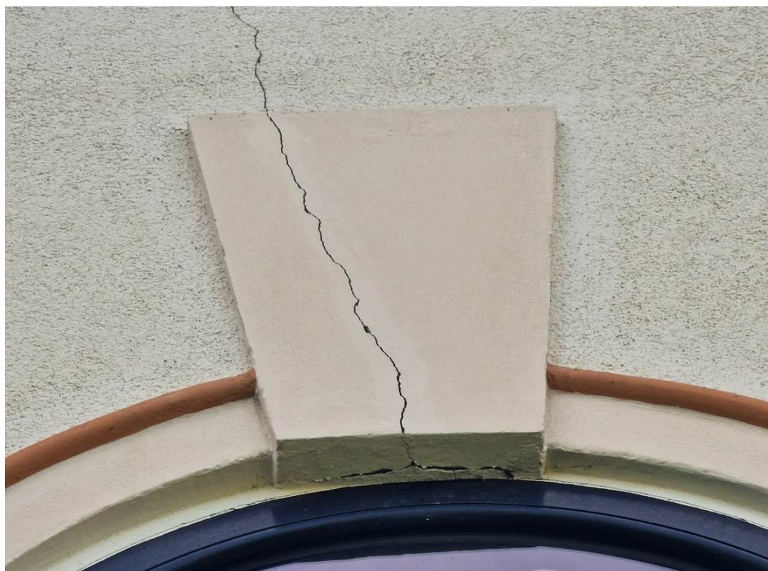
Foto. 25 Widok uszkodzonej (pękniętej) elewacji
