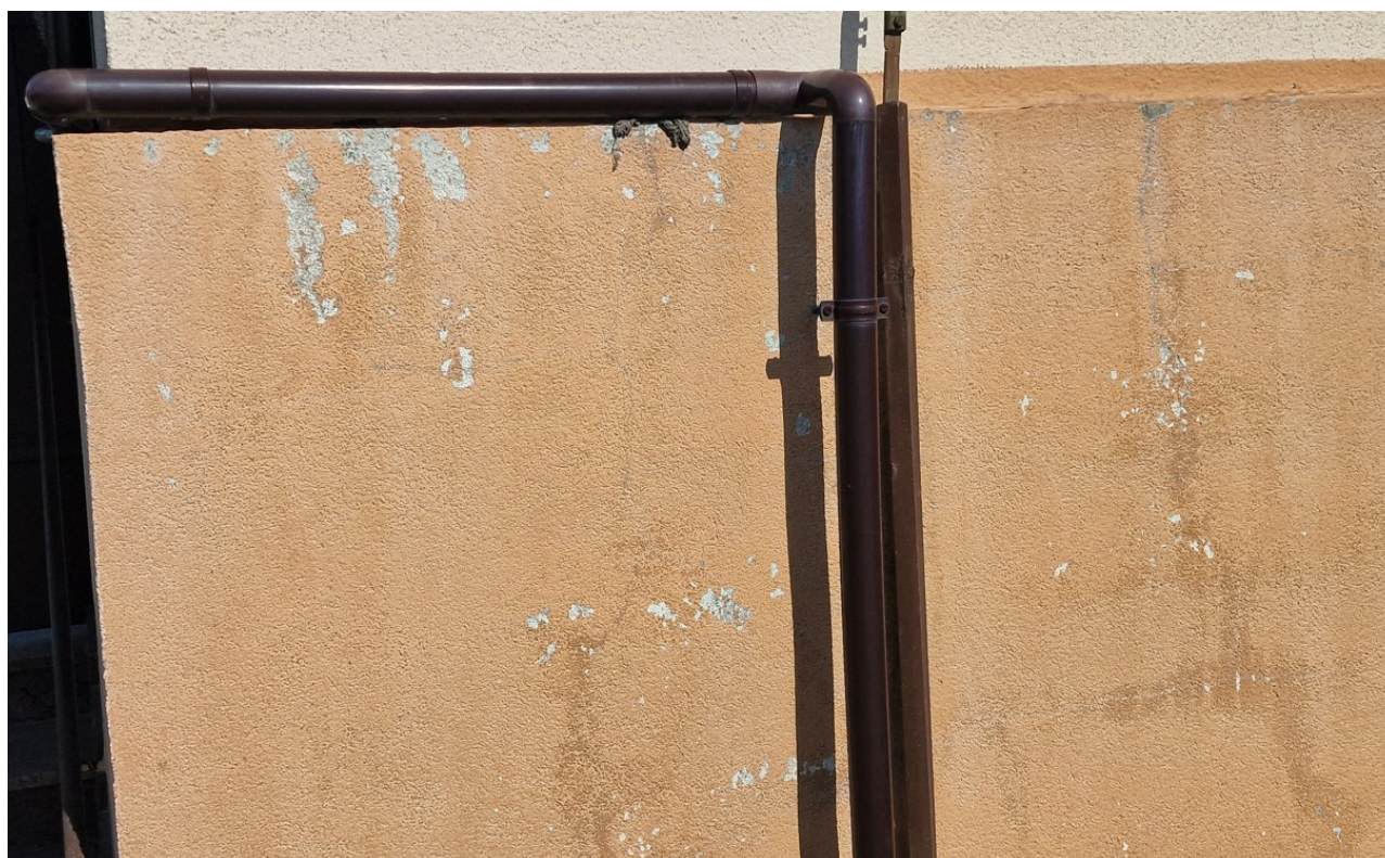
Foto. 7 Widok odpryśniętej farby na cokole
