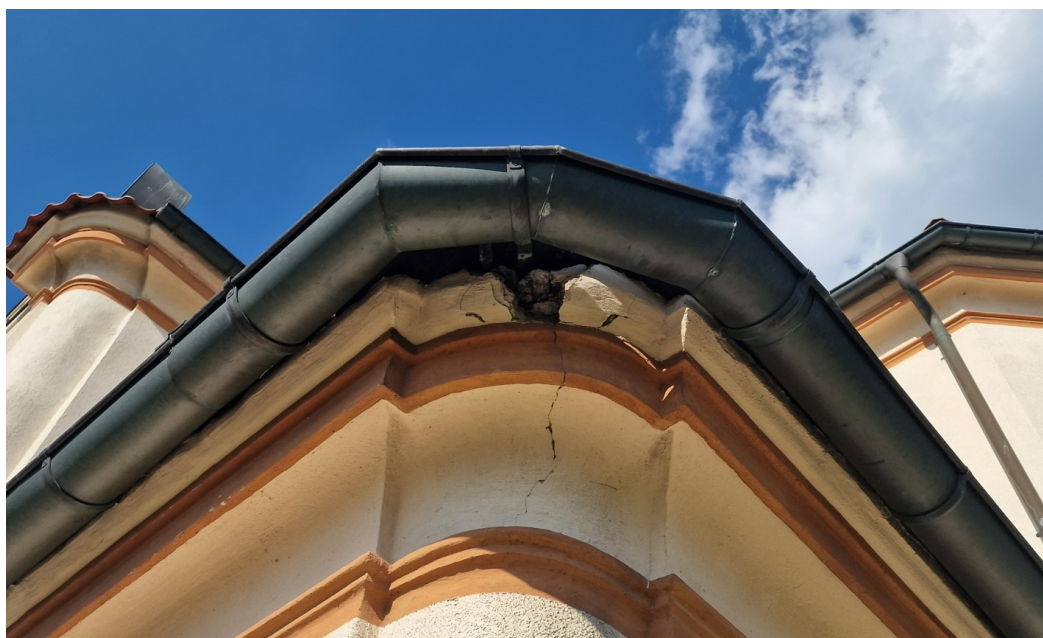
Foto. 15 Widok uszkodzenia gzymsu
