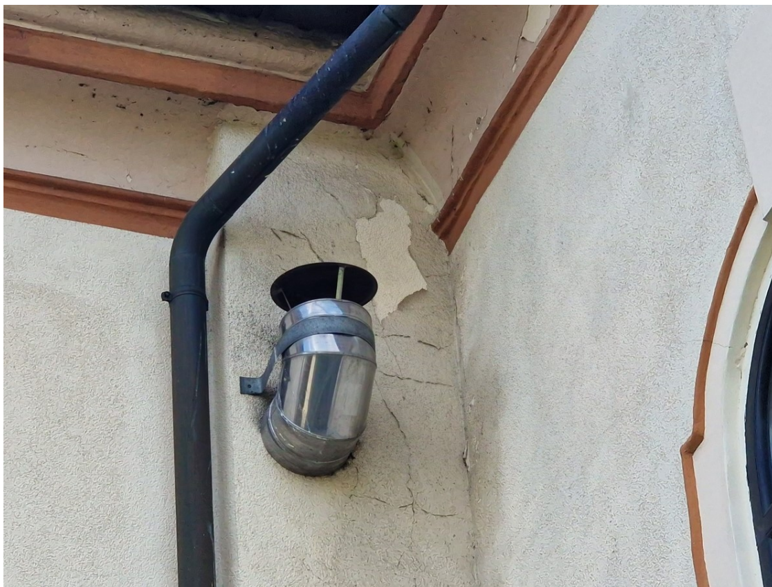
Foto. 18 Widok uszkodzonej elewacji
