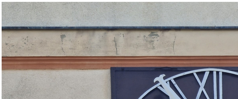
Foto. 5 Widok odprysniętej farby na gzymsie
