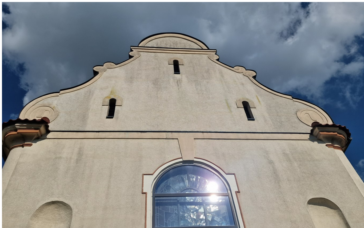
Foto. 8 Widok zabrudzonej elewacji
