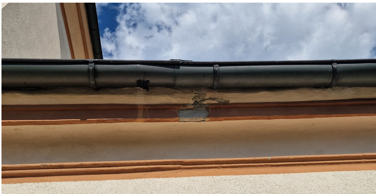
Foto. 13 Widok uszkodzenia gzymsu
