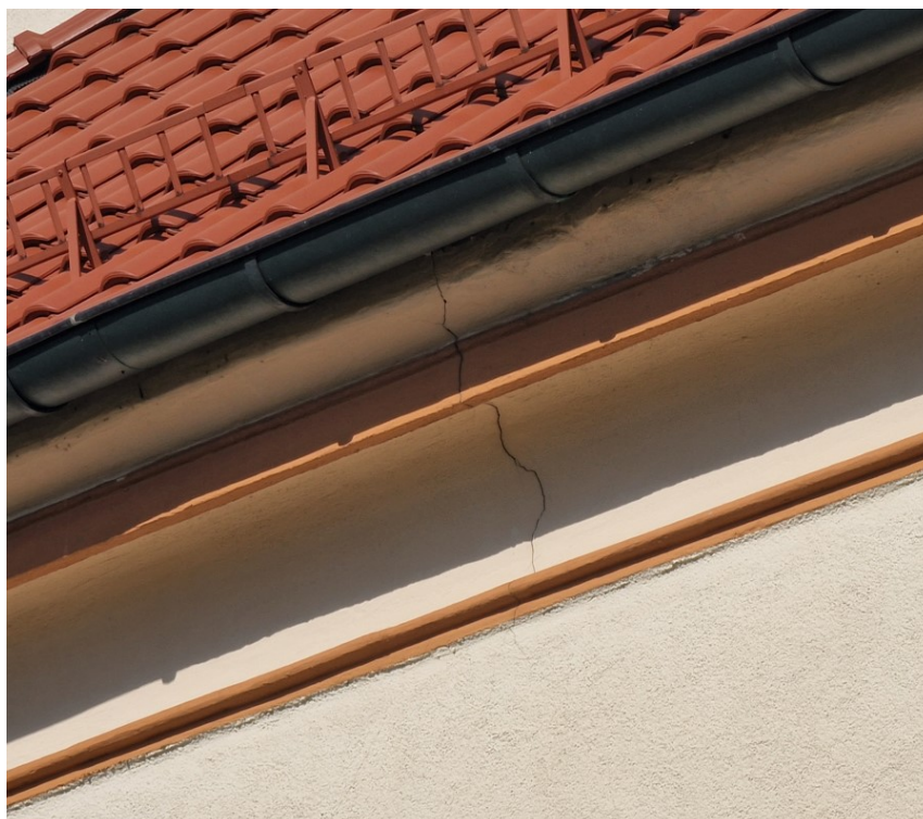
Foto. 9 Widok uszkodzenia (pęknięcia) gzymsu
