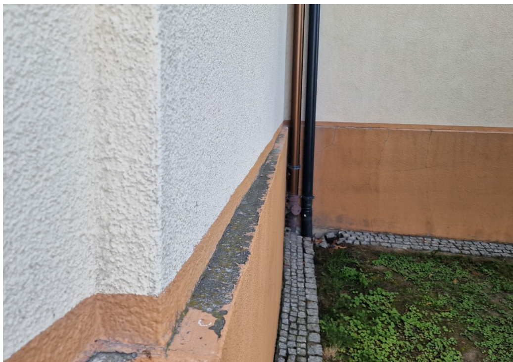
Foto. 23 Widok uszkodzonego cokołu
