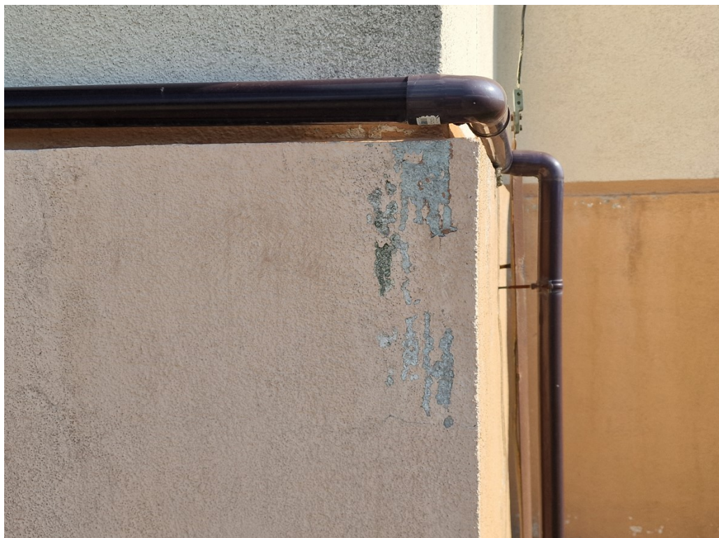
Foto. 6 Widok odpryśniętej farby na cokole
