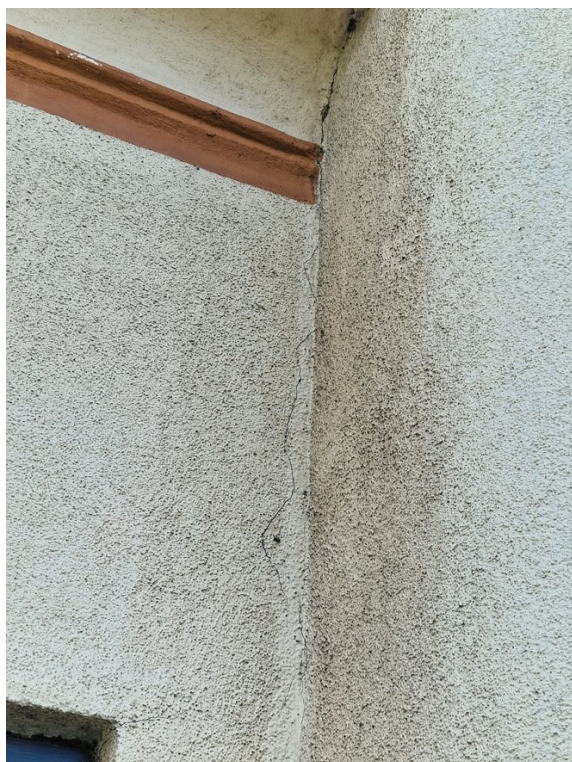
Foto. 21 Widok uszkodzonej (pękniętej) elewacji
