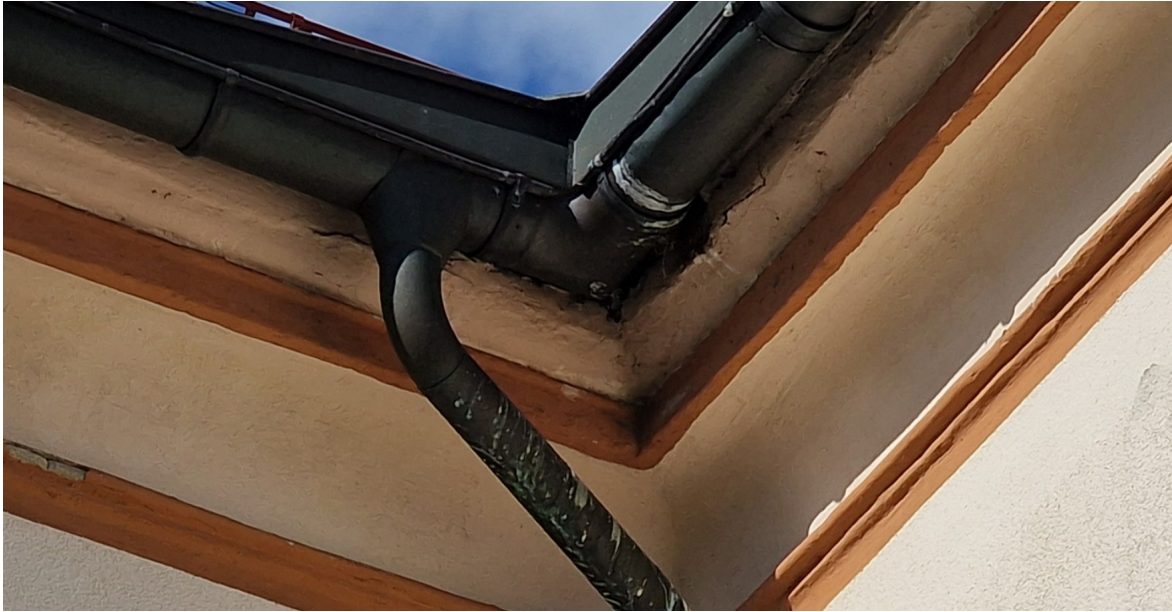
Foto. 16 Widok uszkodzenia gzymsu
