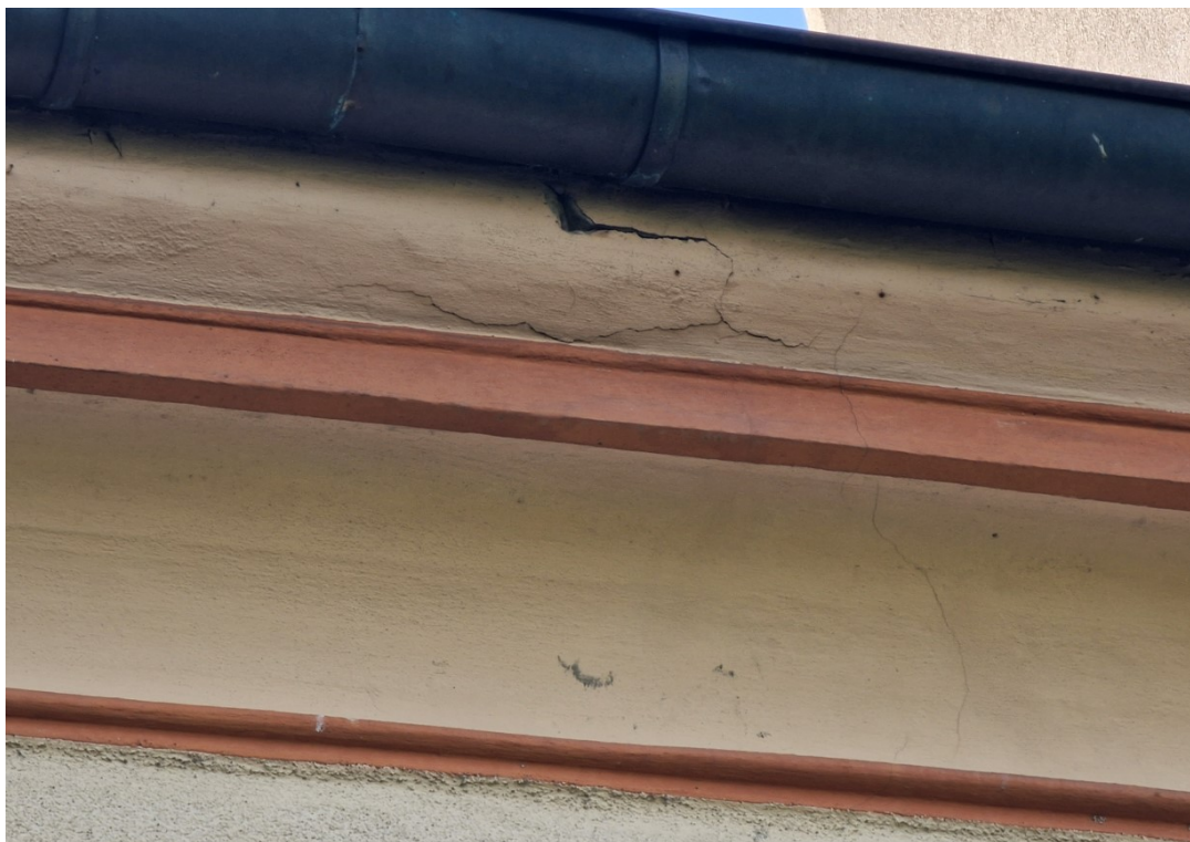
Foto. 24 Widok uszkodzonego gzymsu
