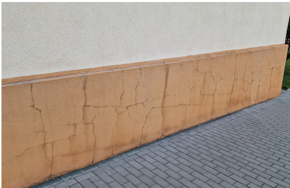
Foto. 22 Widok uszkodzonego cokołu
