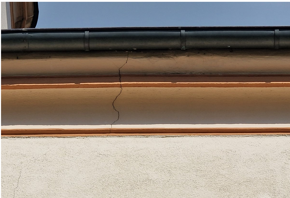
Foto. 10 Widok uszkodzenia (pęknięcia) gzymsu
