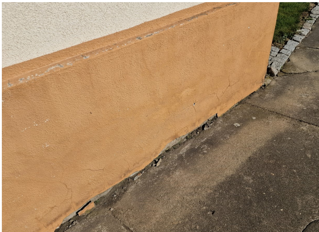
Foto. 14 Widok uszkodzenia cokołu
