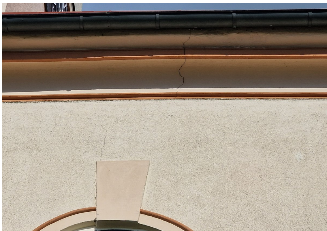
Foto. 11 Widok uszkodzenia (pęknięcia) gzymsu oraz zarysowania nadokiennego
