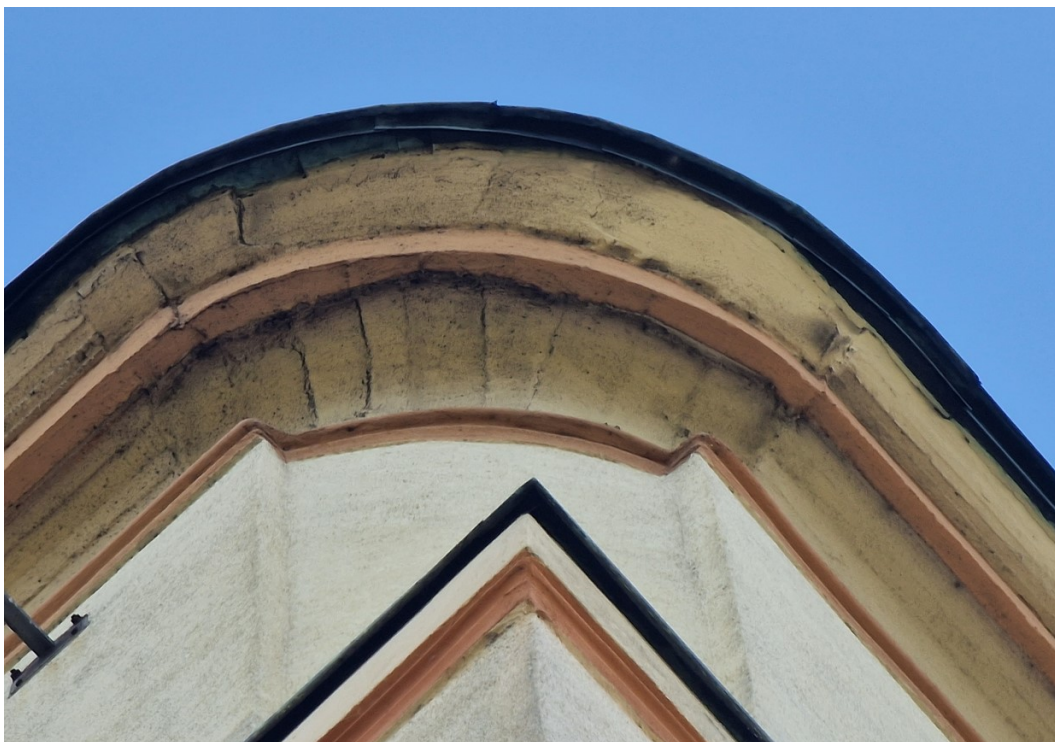
Foto. 26 Widok uszkodzonej i zabrudzonej elewacji
