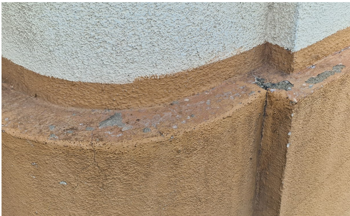
Foto. 20 Widok uszkodzonego cokołu
