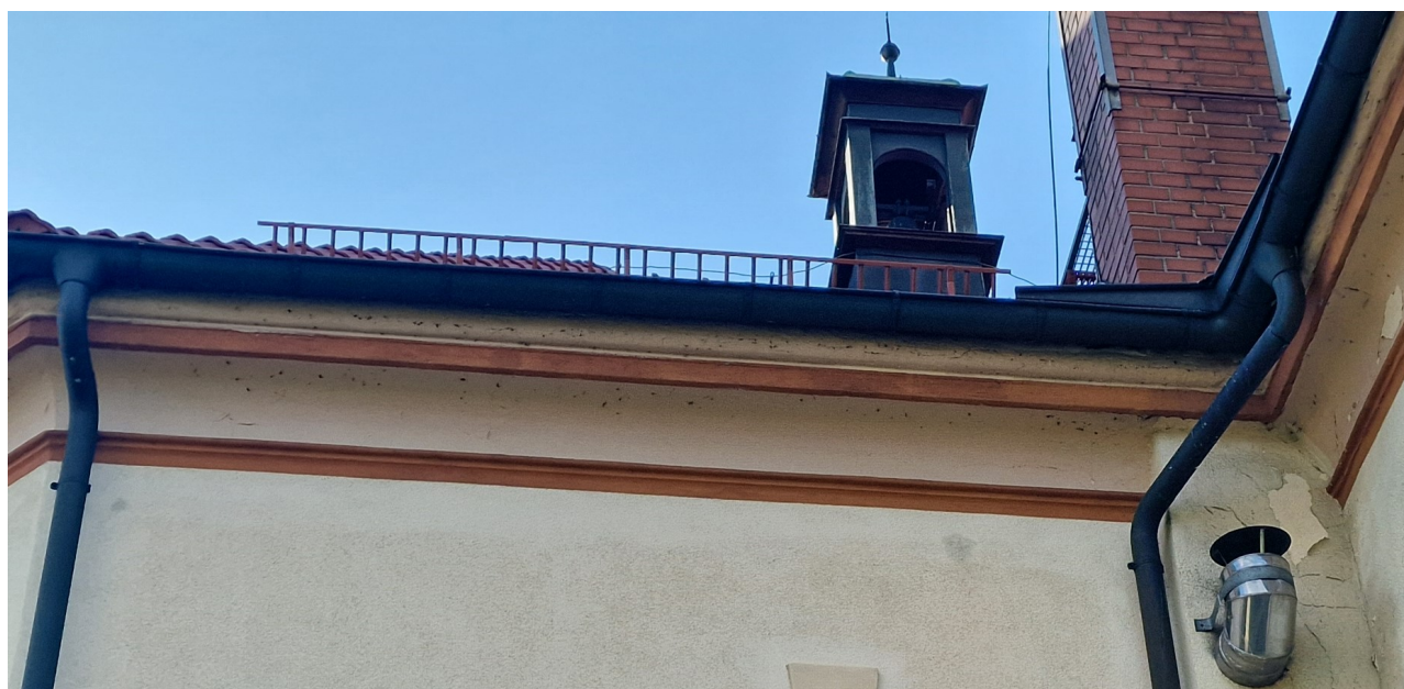
Foto. 19 Widok uszkodzonej elewacji
