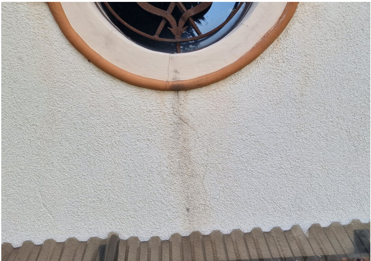
Foto. 17 Widok uszkodzonej elewacji
